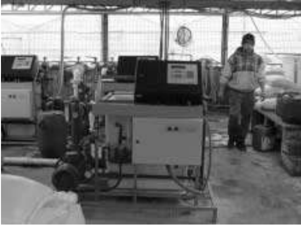
Inyector de fertilizante con control de pH y conductividad eléctrica.
