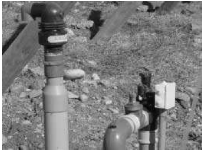
Válvula de aire y válvula de solenoide.
