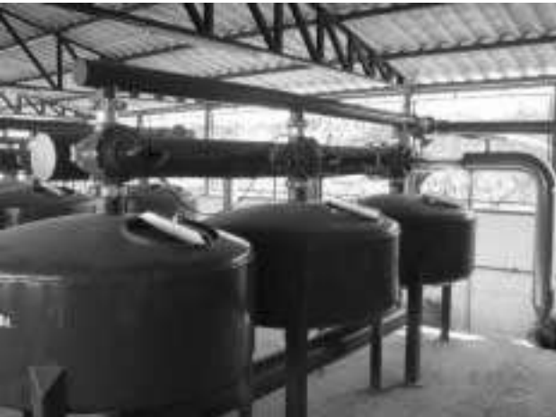
Filtro de grava con válvula de retrolavado.
