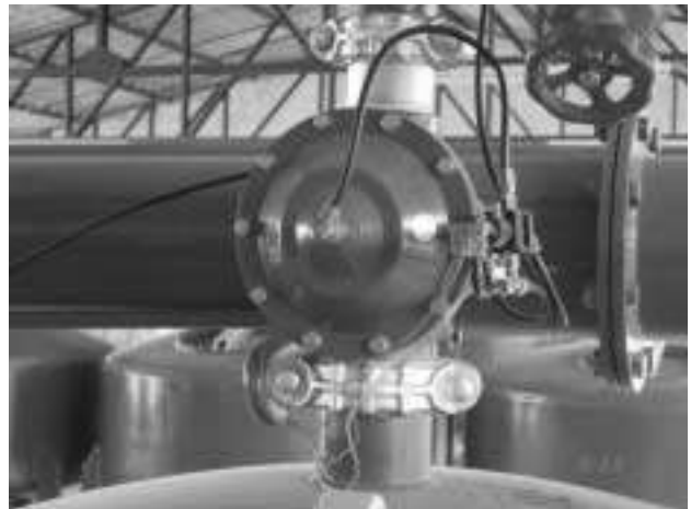
Válvula de retrolavado.
