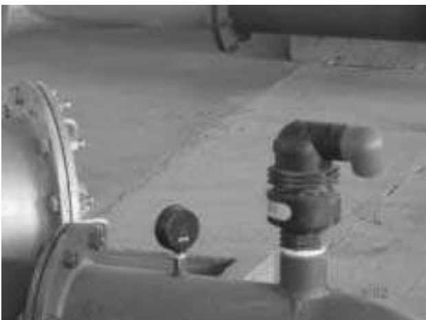
Válvula de aire en el cabezal y manómetro.
