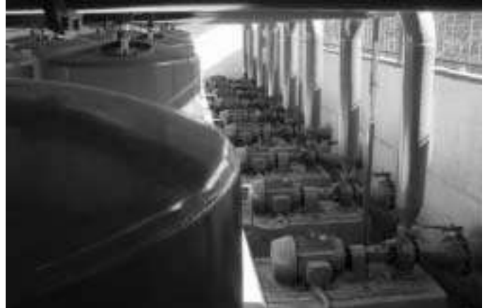
Motobomba centrífuga del cabezal de riego.
