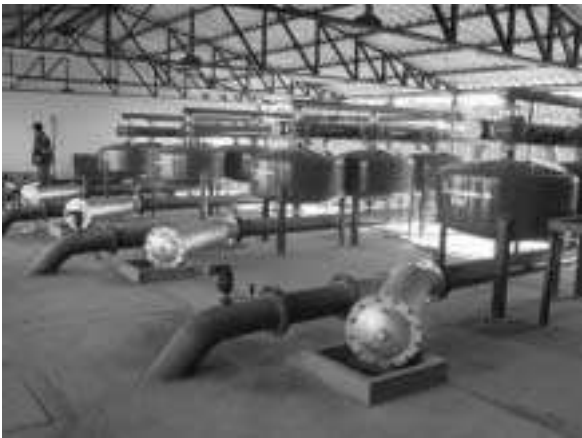
Filtro de grava y filtro de malla.
