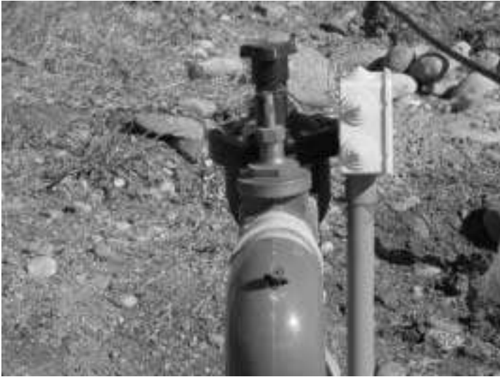
Válvula de solenoide, válvula reguladora de compuerta y toma manométrica.
