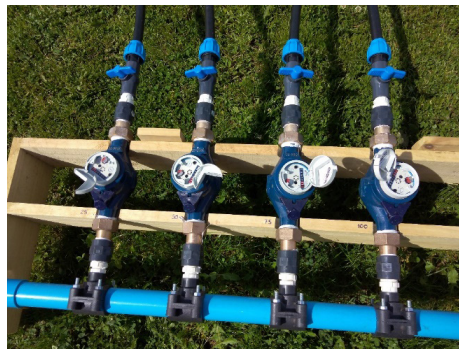
Figura 5.9. Sistema de control de caudales de riego.
