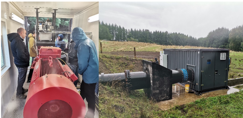
Figura 4.7. Microcentral hidroeléctrica de 164 Kw para uso en sistemas de riego.
