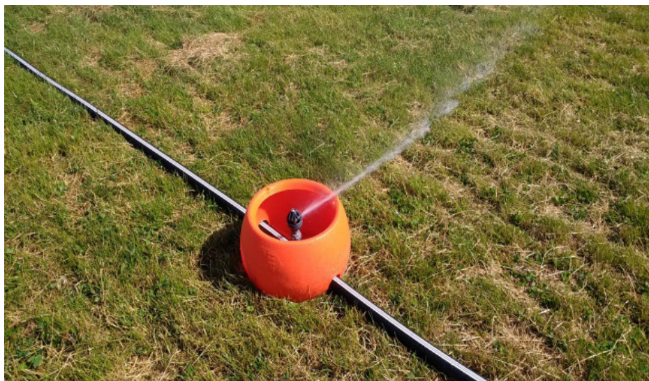
Figura 5.2. Sistema de riego por tazas en una pradera de pastoreo. Detalle de taza de polietileno y aspersor en su interior.
